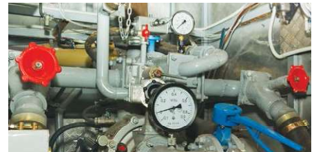
Bombas y control de válvulas
