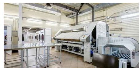
Sistema de lavandería automatizado
